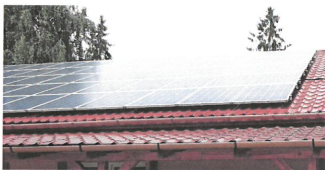
A Községháza tetejét borító napelemek.
